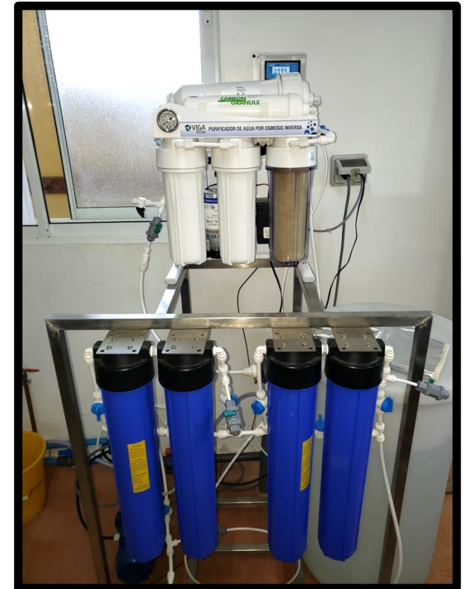
Equipo de Osmosis
